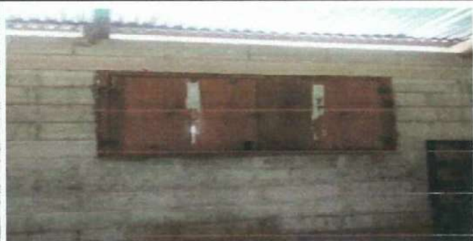
Foto 5: se necesita sustituir las ventanas por metal
