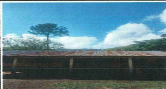
Foto 1: Se necesita cambio de cubierta de lamina e instalaciones de tubo pvc y bajadas de agua pluvial
