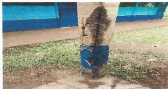
Foto 4: se necesita reforzar columnas modulo 1 de dos aulas
