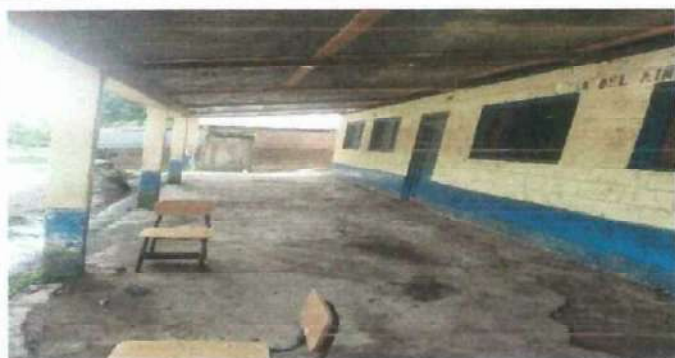
Foto 3: se necesita dar mantenimiento a puertas de madera por metal, y sustitucion de piso de antideslizante
